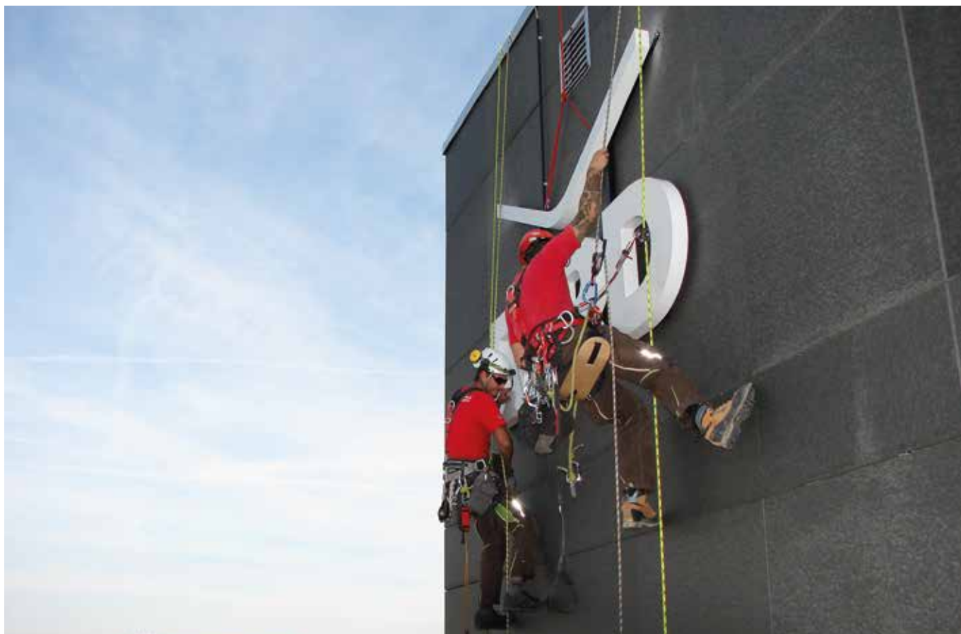
Posa di un'insegna luminosa. Pose d'un enseigne lumineuse. Anbringung einer Leuchtreklame. Genève, Switzerland (courtesy of Corde-Access SA).
