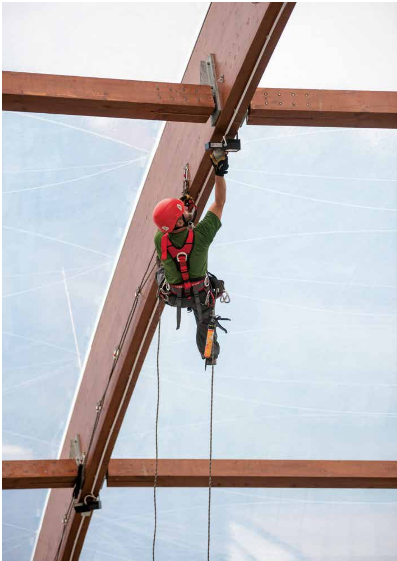
Installazioni elettriche all'interno della cupola dell'Aquapark Nymphaea. Installations électriques à l'intérieur du dôme de l'Aquapark Nymphaea. Elektroinstallationen im Inneren der Kuppel des Aquapark Nymphaea. Oradea, Romania (courtesy of Camp Technical Solutions, ph. Riky Felderer).
