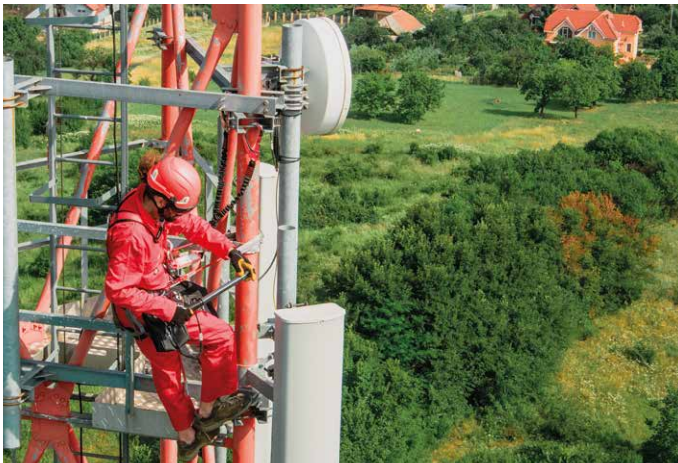
Installazione di antenne su un traliccio per le telecomunicazioni. Installation d'antennes sur un pylône de télécommunications. Installierung von Antennen an einem Fernmeldeturm. Oradea, Romania (courtesy of Camp Technical Solutions, ph. Amazing Visuals Studio).
