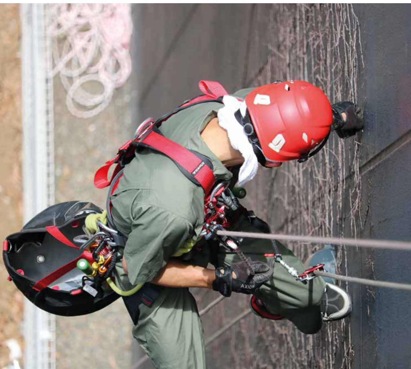
Taizo Fukunaga effettua operazioni di manutenzione in accesso su corda della sede di Caravan. Taizo Fukunaga réalise les opérations de maintenance en accès sur cordes au siège de Caravan. Taizo Fukunaga führt seilunterstützte Wartungsarbeiten in der Caravan-Zentrale durch. Tokyo, Japan (courtesy of Caravan Co. Ltd., ph. Ryuichi Ihara).
