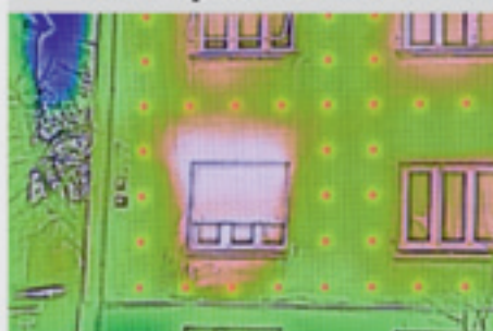
Ancorante tradizionale Ridotta efficienza energetica
